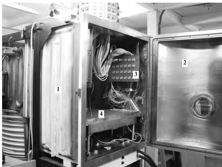
1. Камера 3. Коммутационная панель 2. Крышка 4. Панель СОТР
